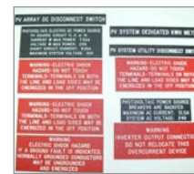
NEC Equip. Labeling
