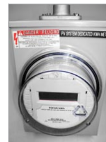
AC kWh Meter & Box
