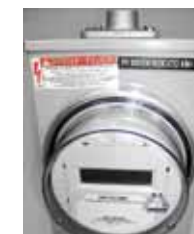
AC kWh Meter & Box
